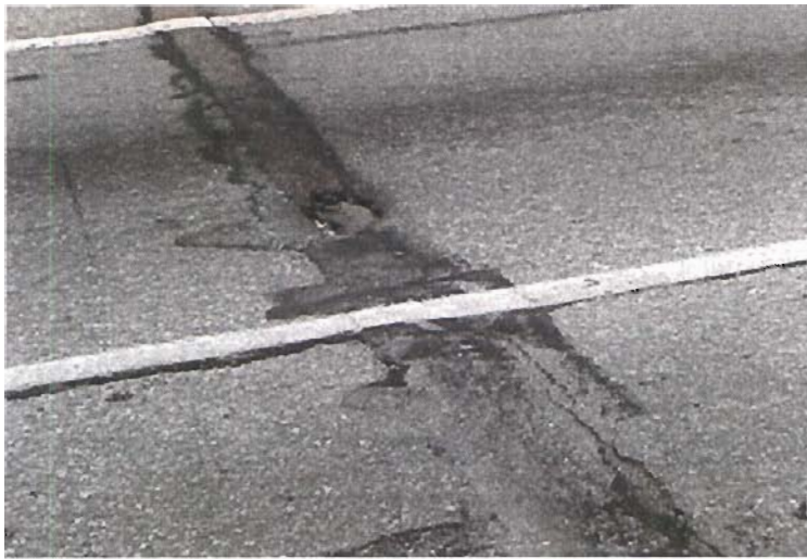
EX. JOINT UNEVEN & LG. VOID
